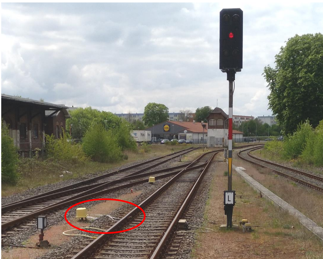
Abb. 6-2 Südliches Ausfahrtsignal L in Parchim aus Gleis 2, rot markierter Achszähler (Foto: Steinfeldt)
