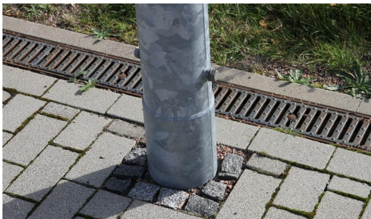
Abb. 6-3 Nicht mit der Rückleitung verbundener Beleuchtungsmast, Schraubverbindungsanschlüsse zur Nachrüstung erkennbar (Foto: Wittemann)
